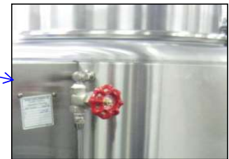
主電源スイッチ
